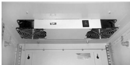
Установленный вентиляторный блок в шкафу
