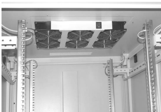
Установленный вентиляторный блок TLK-FAN6-GY в шкафу
