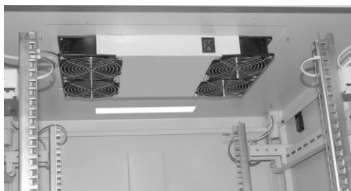
Установленный вентиляторный блок в шкафу
