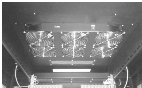
Установленный вентиляторный блок TLK-FAN6-BK
