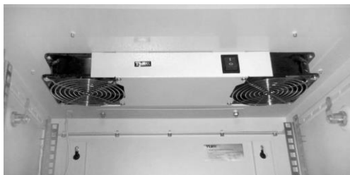
Установленный вентиляторный блок в шкафу
