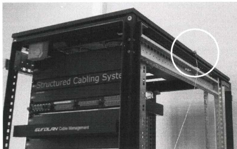
Рисунок А.4 – Расположение акселерометра 333В40, регистрирующего колебания металлоконструкции напольного шкафа типа Rackserv в горизонтальном направлении 0X
